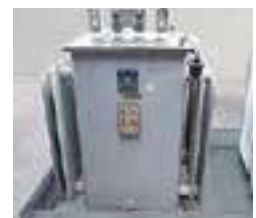
高圧トランスの例
