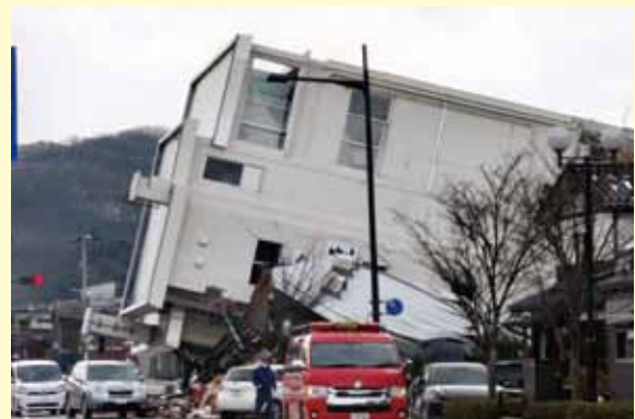
倒壊したビル
