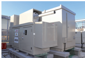
非常用発電設備(3日間以上の燃料備蓄)
